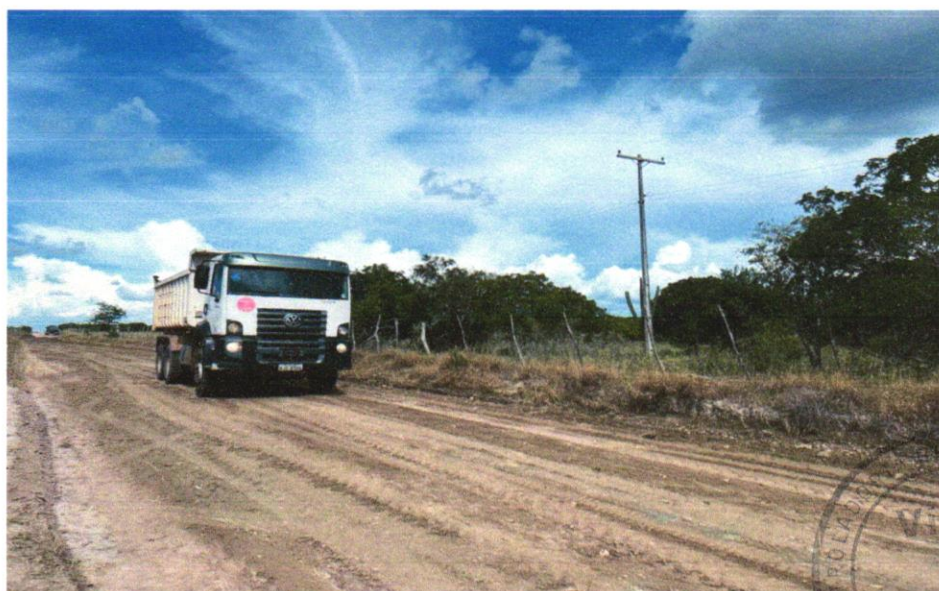
FOTO 04 - TRANSPORTE COM CAMINHÃO BASCULANTE DE 6 M 3 , EM VIA URBANA EM LEITO NATURAL (UNIDADE: M3XKM). AF_07/2020
