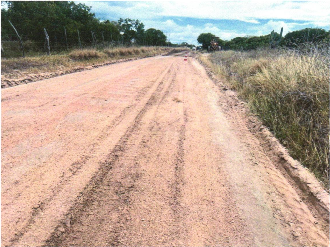
Foto 09 - EXECUÇÃO E COMPACTAÇÃO DE ATERRO COM SOLO PREDOMINANTEMENTE ARGILOSO - EXCLUSIVE SOLO, ESCAVAÇÃO, CARGA E TRANSPORTE. AF_11/2019
